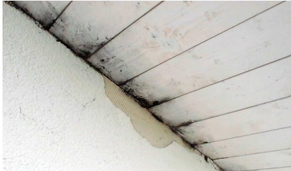
Bauschäden wie beispielsweise im Bild oben gilt es frühzeitig zu vermeiden.
